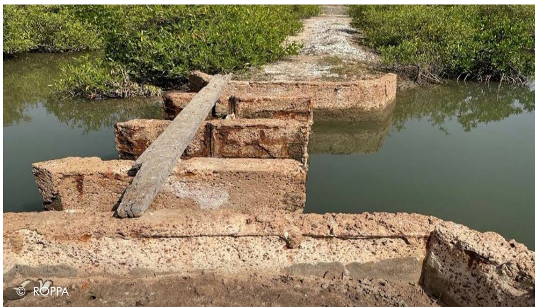
Barrage vétuste, source de salinisation des terres agricoles, à rénover
